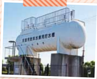
災害用飲料水兼用貯水槽 貯水量は4万リットルあります！
