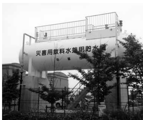
▲災害用飲料水兼用貯水槽(総合福祉センター内)
