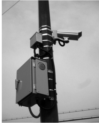
設置された防犯カメラ
