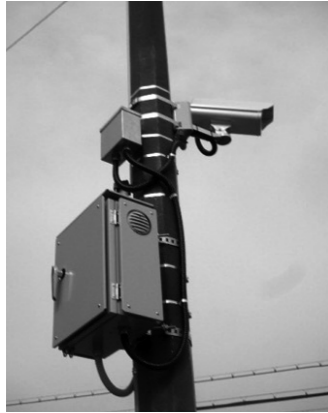
設置された防犯カメラ
