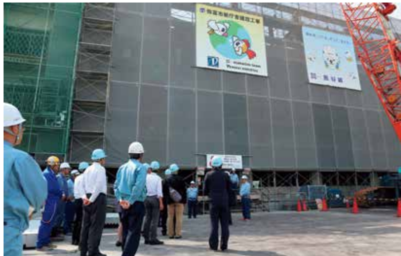
▲視察日現在、庁舎4階床までの躯体工事がほぼ完了していました
