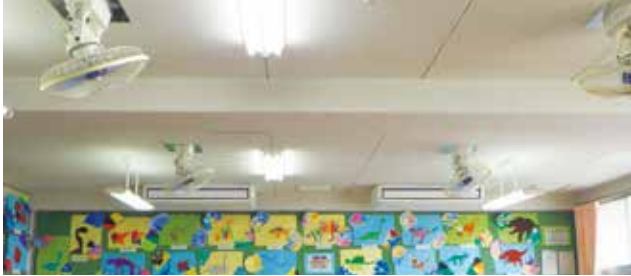
▲エアコンが設置された小学校普通教室（白鳥小学校）
