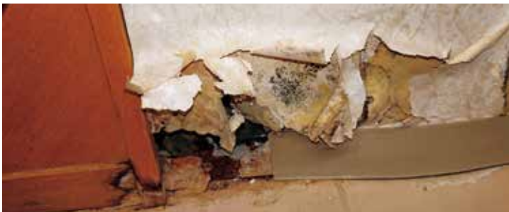
▲雨漏りにより早期修繕が必要な白鳥コミュニティセンター
