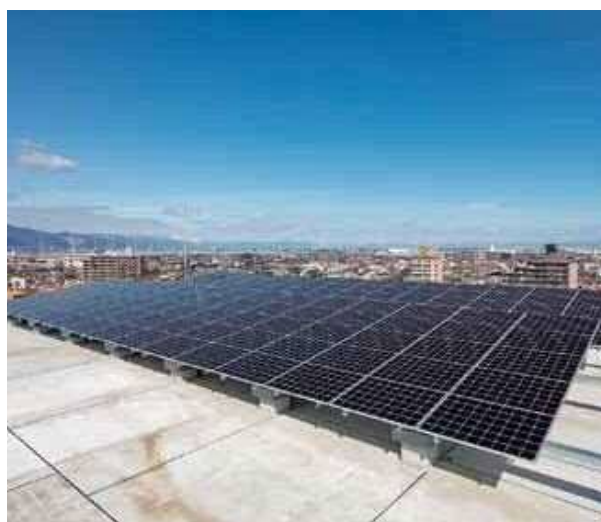
太陽光パネル (屋上)
