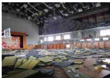
▲崩落した特定天井 避難所(体育館)2016年熊本地震
