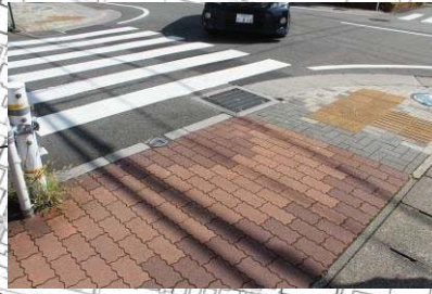
・横断歩道幅に対して点状ブロックの設置幅が狭い
