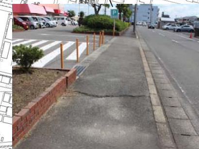
・歩道部のひび割れ
