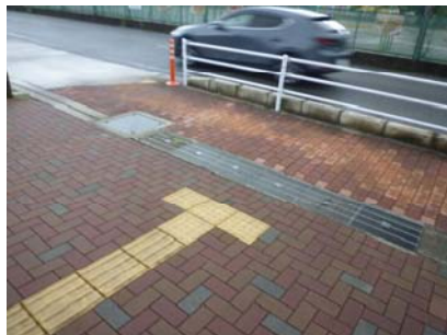
・途切れている視覚障害者誘導用ブロック
