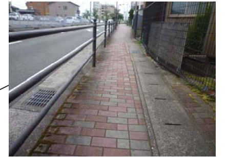
・歩道幅が狭く勾配のきつい箇所あり
