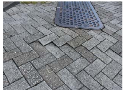
・ 歩道の路面の凸凹
