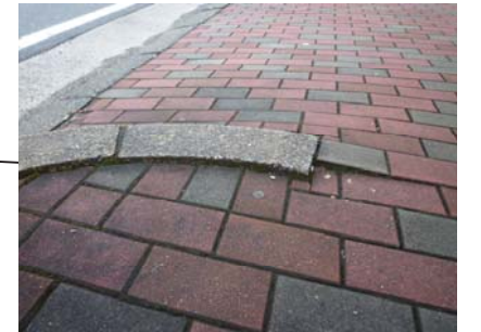
・段差のある歩道
