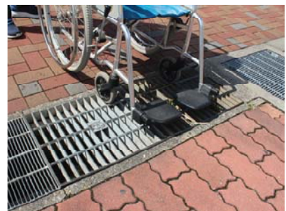
・ 溝幅の広いグレーチング蓋
