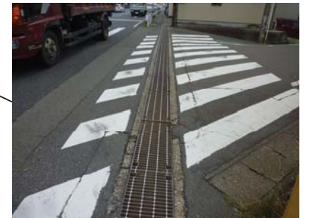
・溝幅の広いグレーチング蓋
