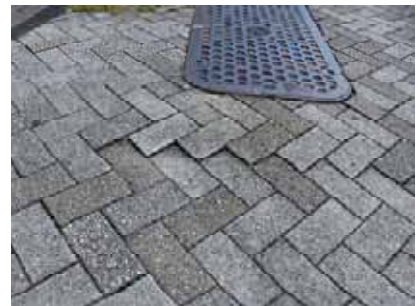
・ 歩道の路面の凸凹
