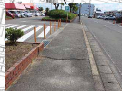
・歩道部のひび割れ
