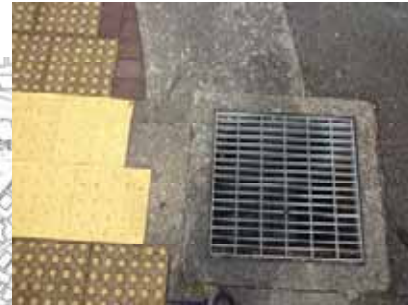
・溝幅の広いグレーチング蓋
