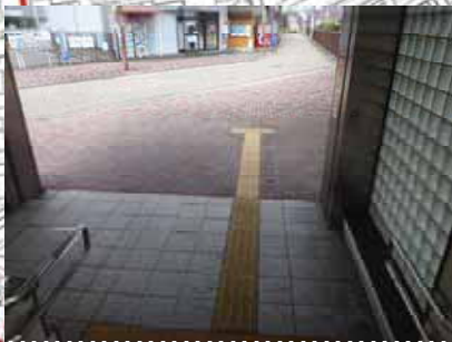
・視覚障害者誘導用ブロックの途切れ
