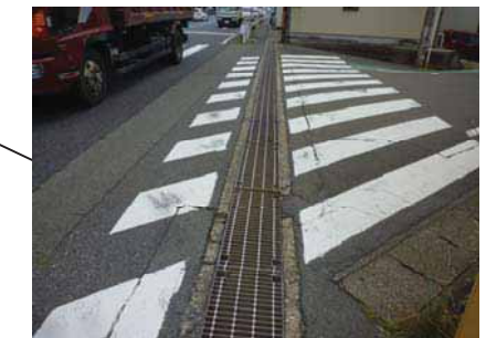
・溝幅の広いグレーチング蓋
