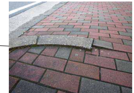
・段差のある歩道
