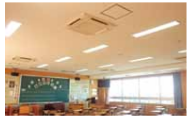
▲日の出小学校音楽室内エアコン
