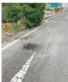
▲穴があいた道路
