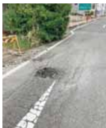
▲穴があいた道路
