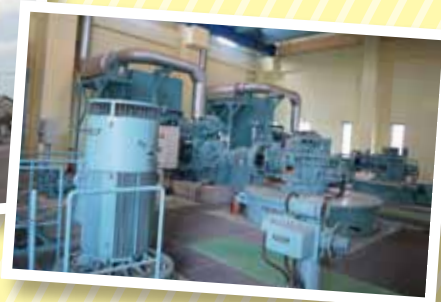
◀鍋田南部排水機場内部
