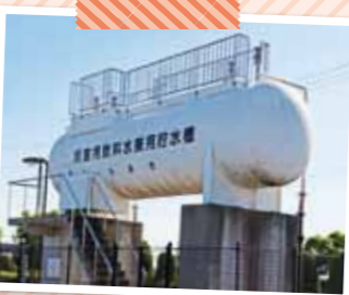
災害用飲料水兼用貯水槽 貯水量は4万リットルあります!
