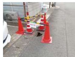
▲市内道路陥没事例
