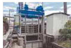
▲佐古木地区揚水ゲート
